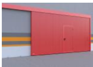
Противопожарные одностворчатые ворота, установленные в производственном помещении
