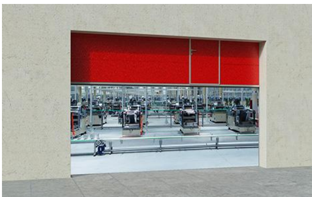
Секционные противопожарные ворота, устанавливаются в промышленных и складских помещениях.
